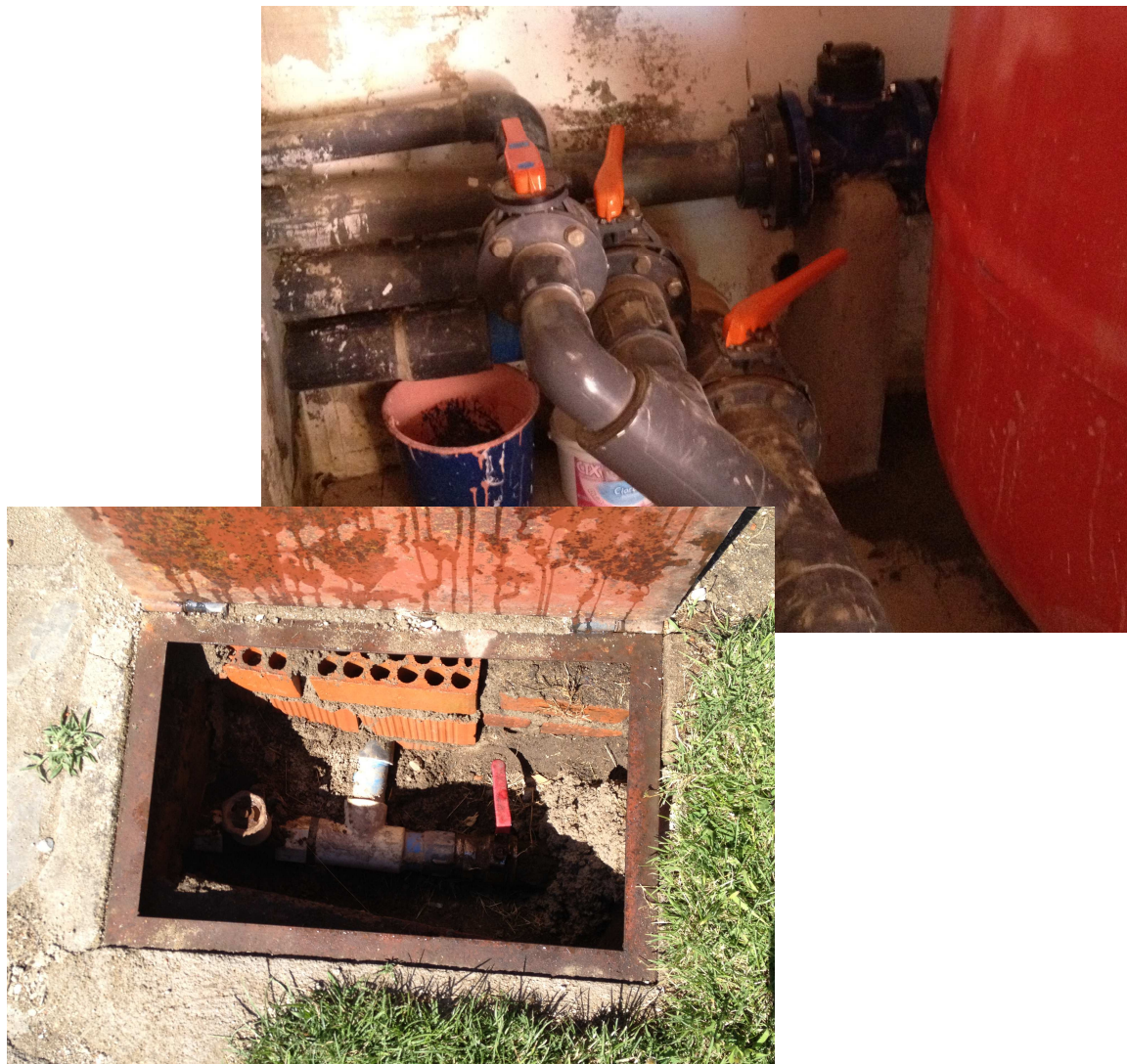
Caudalímetros instalados en el cuarto de depuración y en arqueta de circuito de impulsión.
